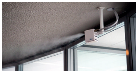
Direkt-Raumluftbefeuchtung bei BHS in Bad Vilbel.
