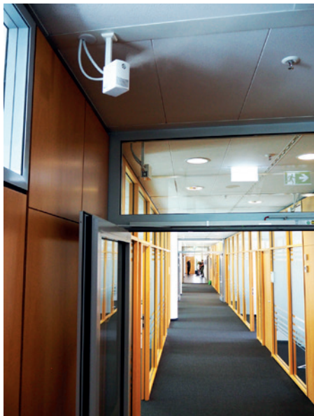
Individuelle Luftbefeuchtung in den Fluren.
